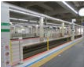
整備済の昇降ロープ式ホームドア (大阪阿部野橋駅)
