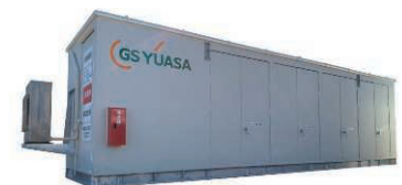
市が尾変電所に設置する 大規模蓄電池
