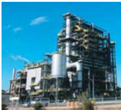
バイオマス発電プラント
