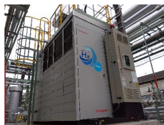
名古屋工場 水素ボイラー
