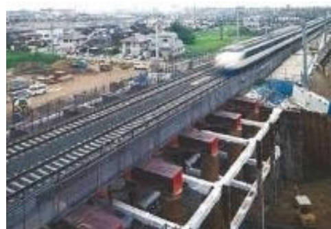
Tokaido Shinkansen Minowa Overpass
