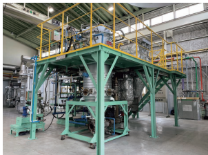
火炎内処理設備の受注も継続
