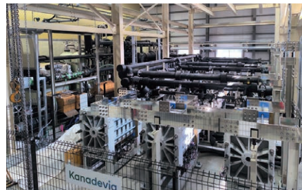
当社が導入した6MW級水電解装置
