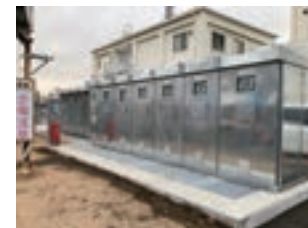
高圧受配電設備
