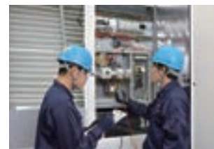
データセンター冷却設備
