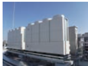
空調設備機器
