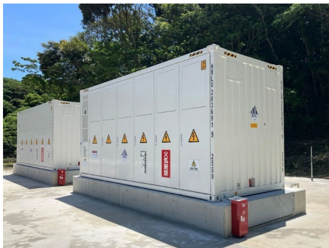
いちご御宿岩和田ECO蓄電所
