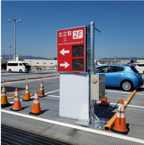
北立駐エリアの満空状況を表示する満空看板
