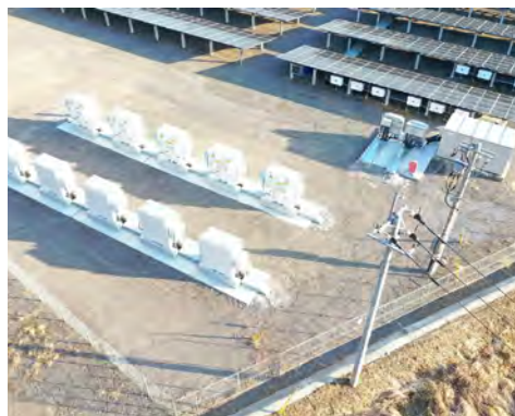
鹿児島伊佐太陽光発電所併設蓄電所（鹿児島県伊佐市） 上：太陽光発電所/下：蓄電池
