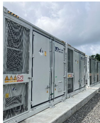
▲「ADW 熊本益城町蓄電所」
