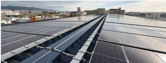
伊丹営業センター太陽光パネル
