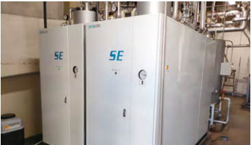
阿久根食肉流通センターLNGボイラー
