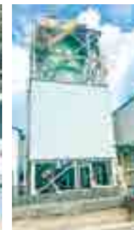
新設した破砕後プラスチック貯蔵サイロ(赤穂工場)
