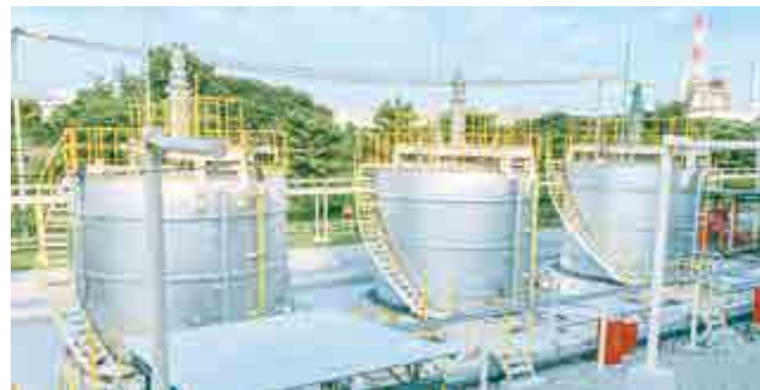
増設した廃油タンク(赤穂工場)
